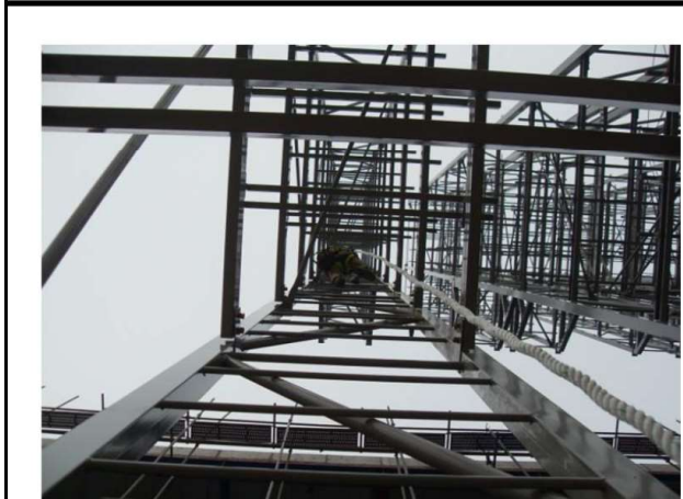
Rack 승,하강 사다리로 승강 모습
