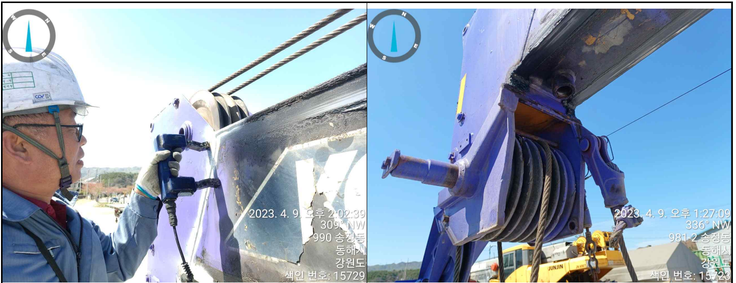
19 4단뿔 용접부 균열확인(자기탐상) 20 시브상태 확인
